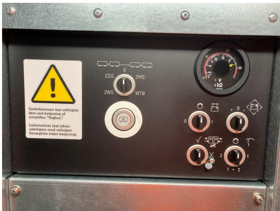
Advarselstrekant påklisteret ved Togbusomskifteren
