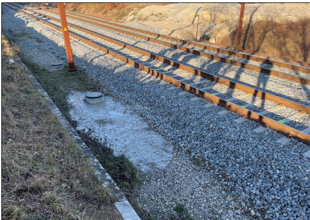
Foto 2. Boremudder ses oven over drænledning omkring sandfangsbrønd på banens vestlige side. Kilde: Banedanmark.
